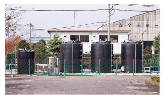
工業用水処理設備例(ダイヤライト施工)
